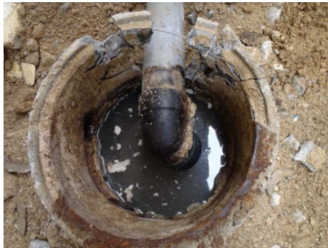
コンクリートが老朽化により破損
